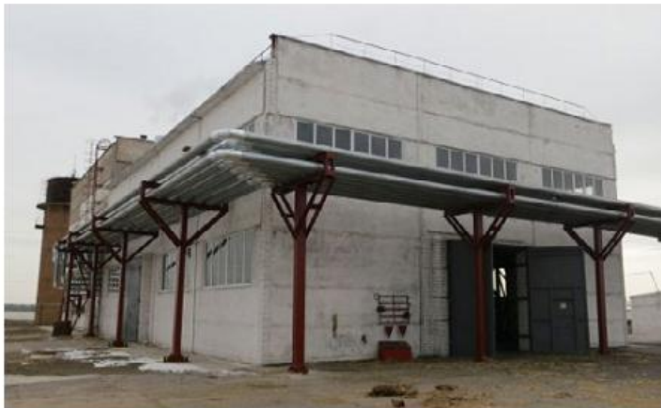
Рис. 4.4. Котельня 10 МВт на тюках соломи птахокомплексу Дніпровський в с. Першотравневе Нікопольського району Дніпропетровської області 56 .
