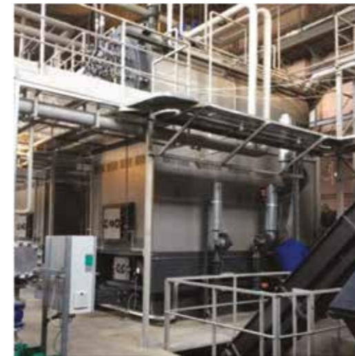
Рисунок 21 – Загальний вигляд приміщення котельні КП ВМР "Вінницяміськтеплоенерго"
